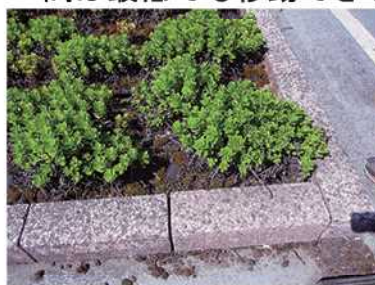
施工後9年が経過した袋
